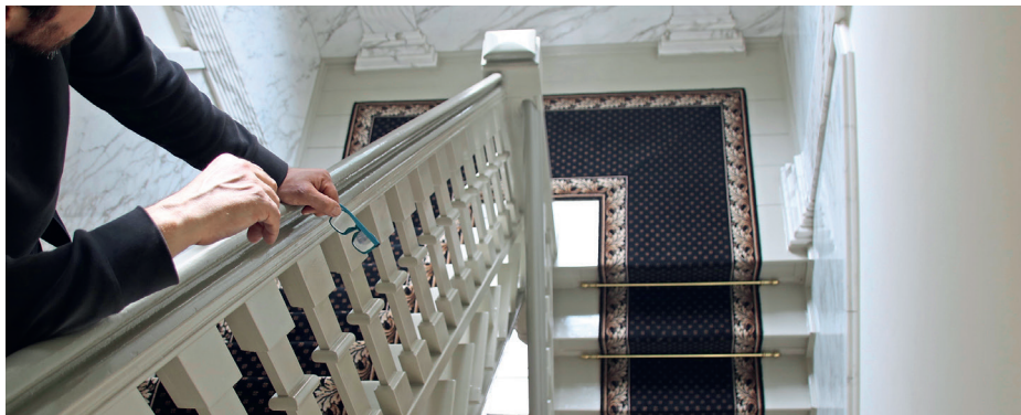
In Potsdam sollte ein gemusterter Läufer im unteren Bereich des Treppenhauses verlegt werden – eine interessante Aufgabe für Mike Zimmermann und sein Team.
